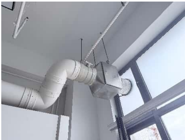
废气处理设施
