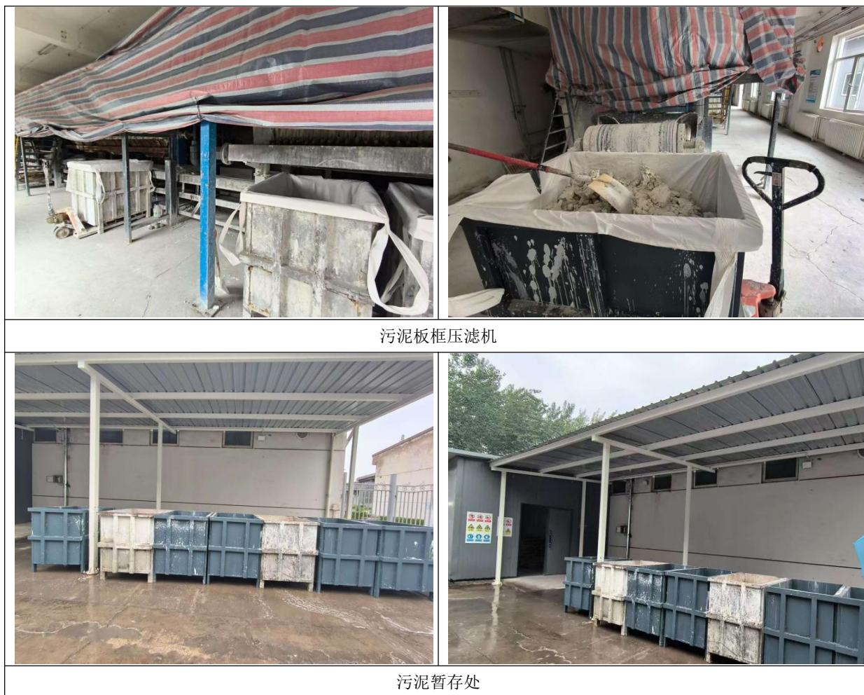
图 2.3-2 板框压滤机及污泥贮存库
