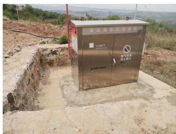
天然气调压柜
