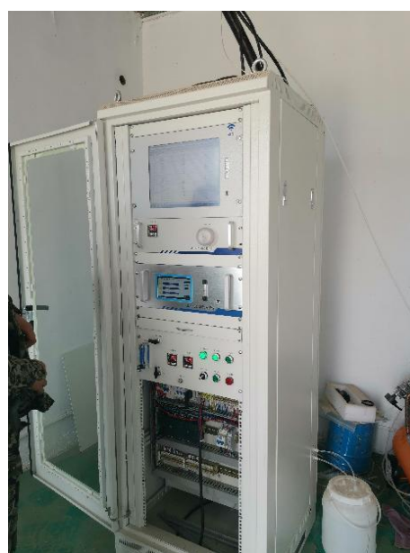
烟气排放连续监测系统
