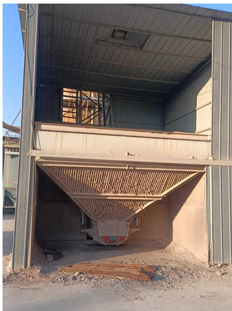
2#生产设施上料口
