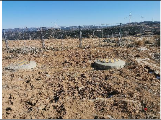
污水地理式一体化处理设施
