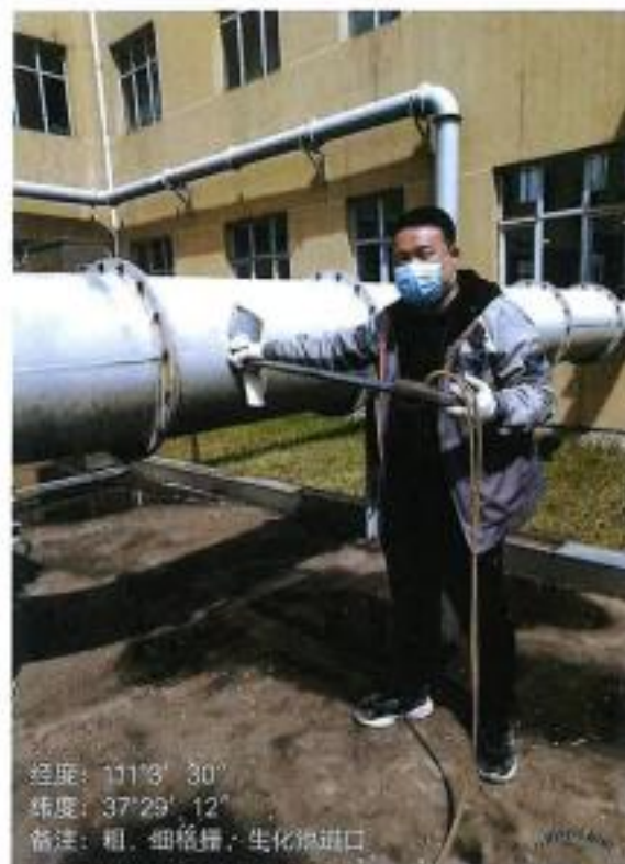
细格栅、曝气沉砂池除臭设备、缺氧组合池除臭设备进口 4#
