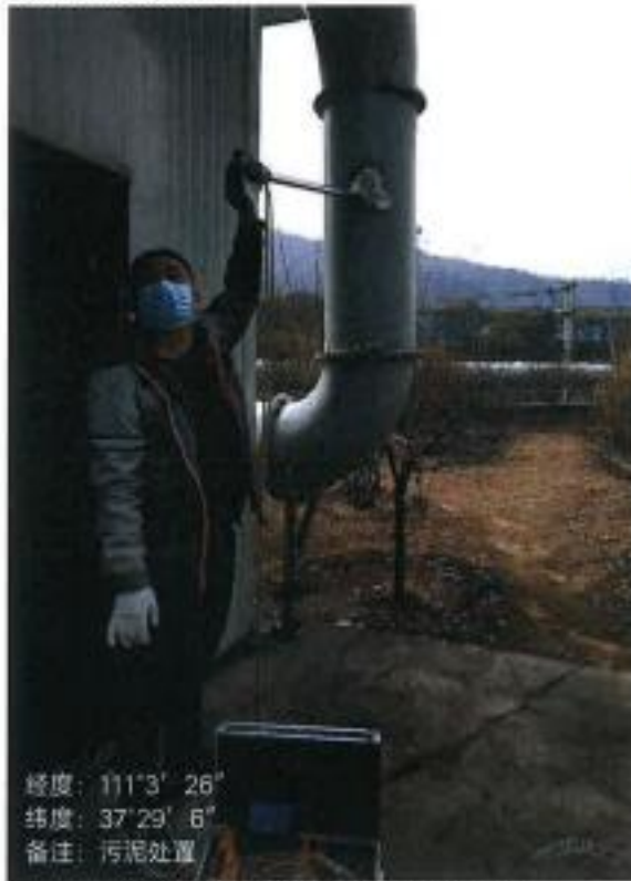
污泥处置中心除臭设备进口 1#
