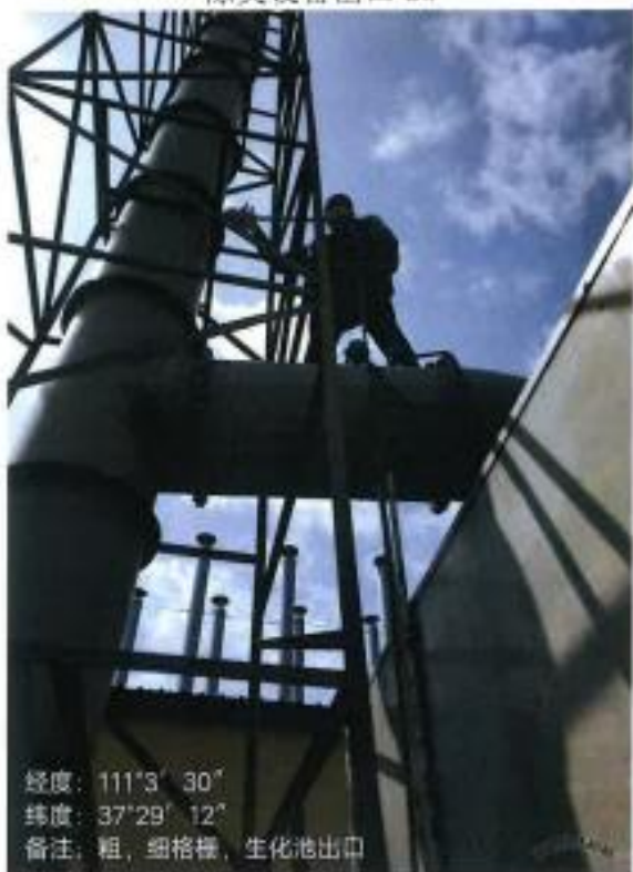
细格栅、曝气沉砂池除臭设备、缺氧组合池除臭设备出口 5#
