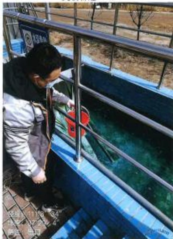
污水处理厂进口 1#
