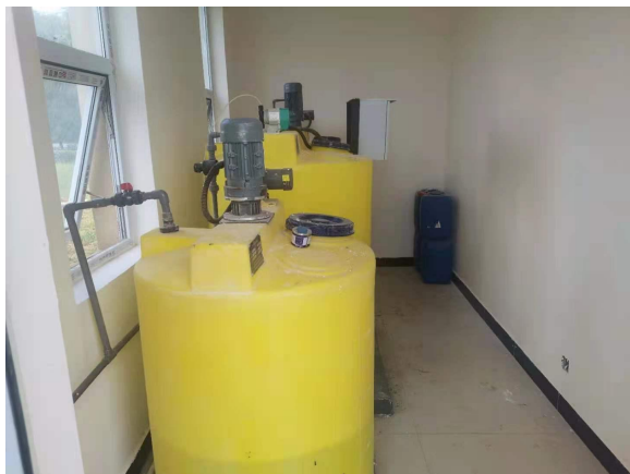
污水处理站药剂间
