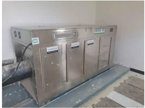
污水处理站恶臭处理设施
